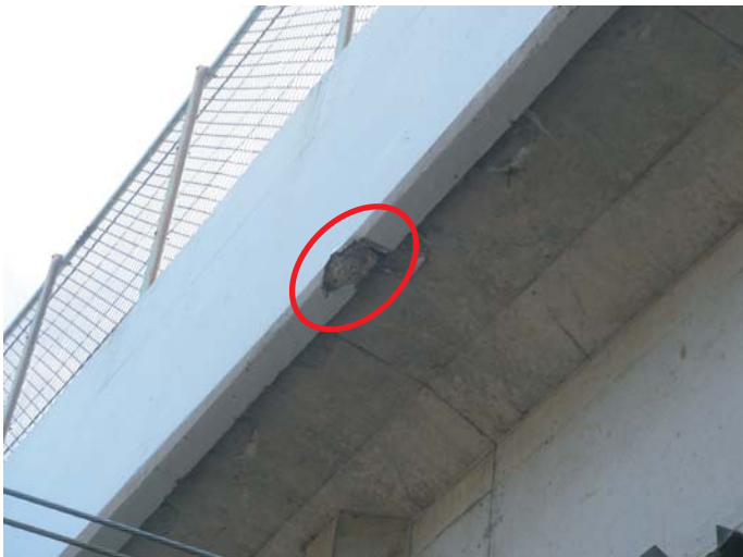
剥落した箇所
